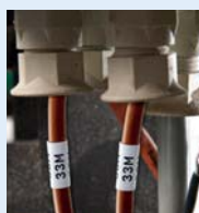
Kennzeichnung im elektrischen Bereich
