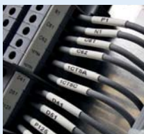
Leitungs- und Kabelkennzeichnung
