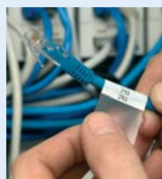
Etiketten und Schrumpfschläuche für die Kabelkennzeichnung
