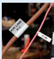
Kennzeichnung im elektrischen Bereich
